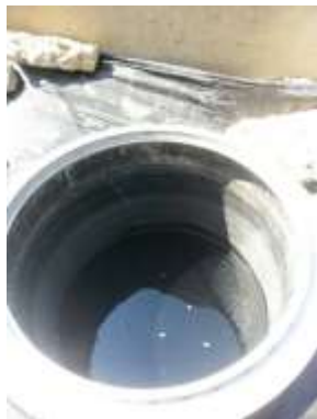
過高的地下水位
